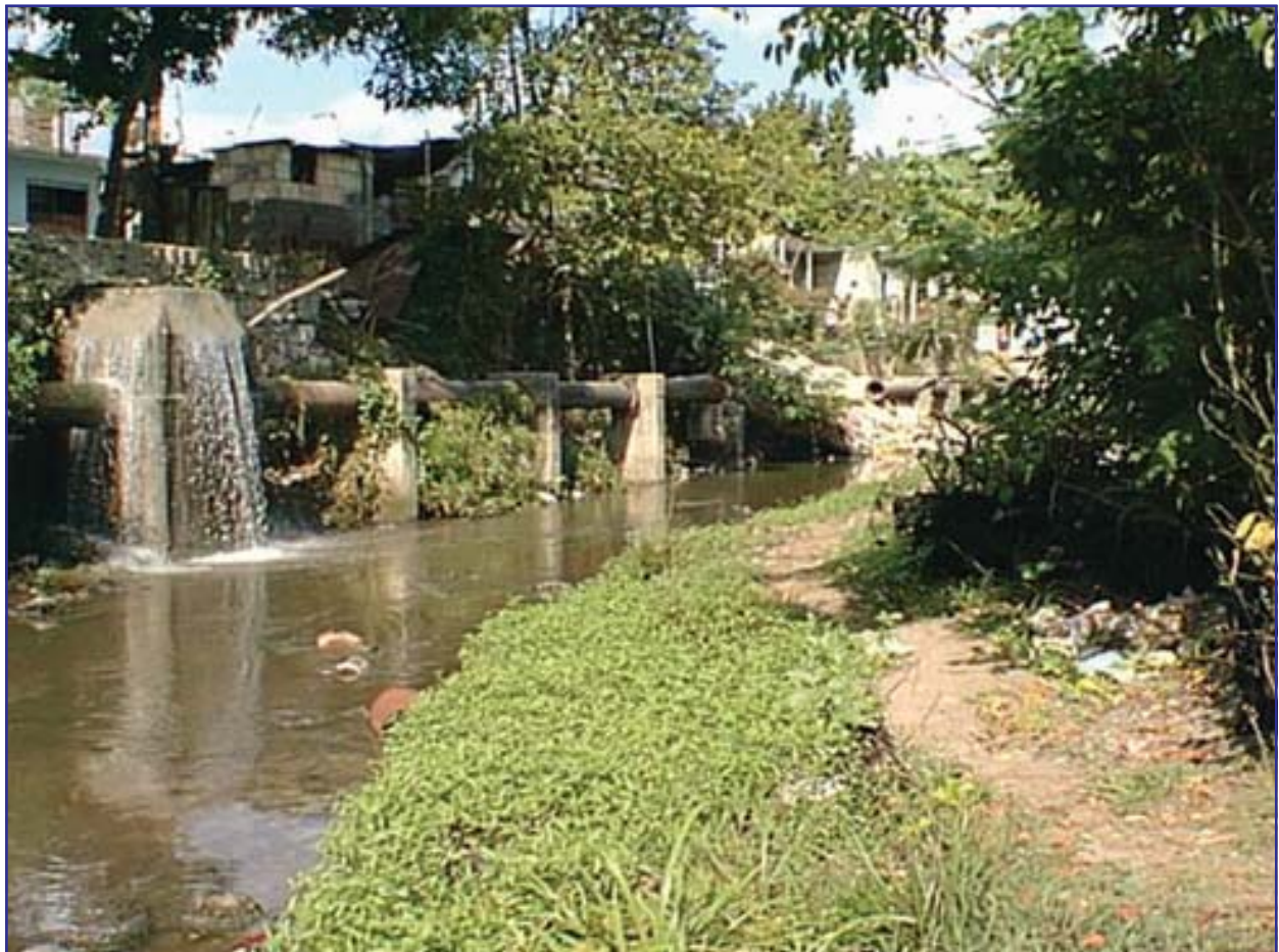
Fig. 2. Vertimiento de residuales a las aguas fluviales por roturas de tuberías del alcantarillado.
